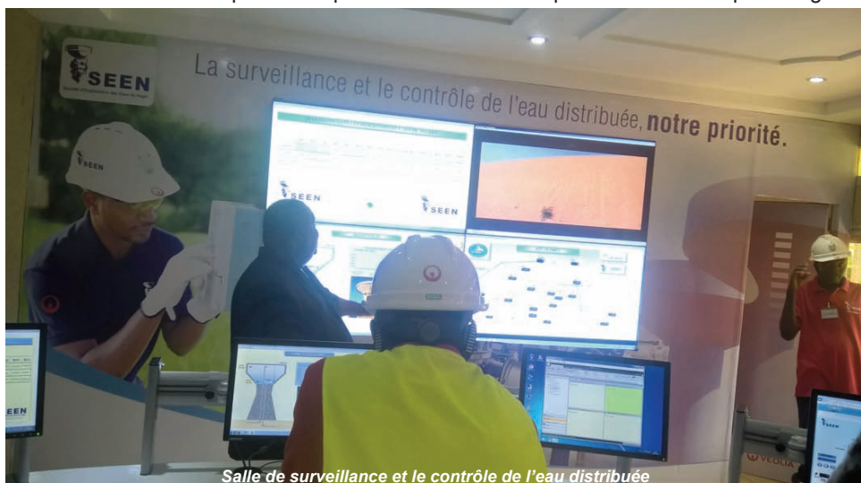
Salle de surveillance et le contrôle de l'eau distribuée
