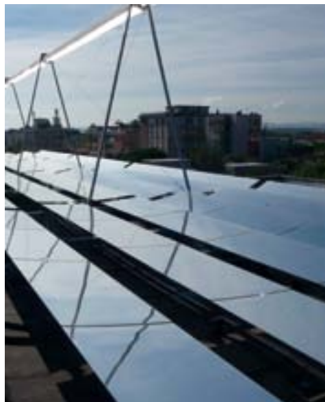
Impianto solare a concentrazione, Comune di Rimini
