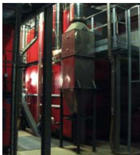
Impianto a biomasse, Comune di Rosà (VI)
