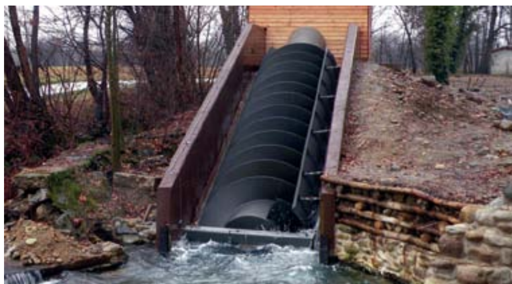
Impianto mini idroelettrico a vite di archimede, Comune di Oglianico (TO)
