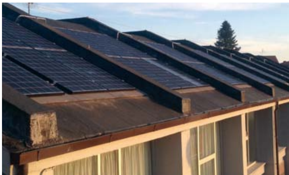
Pannello solare fotovoltaico su scuola materna, Comune di Sarteano (SI)
