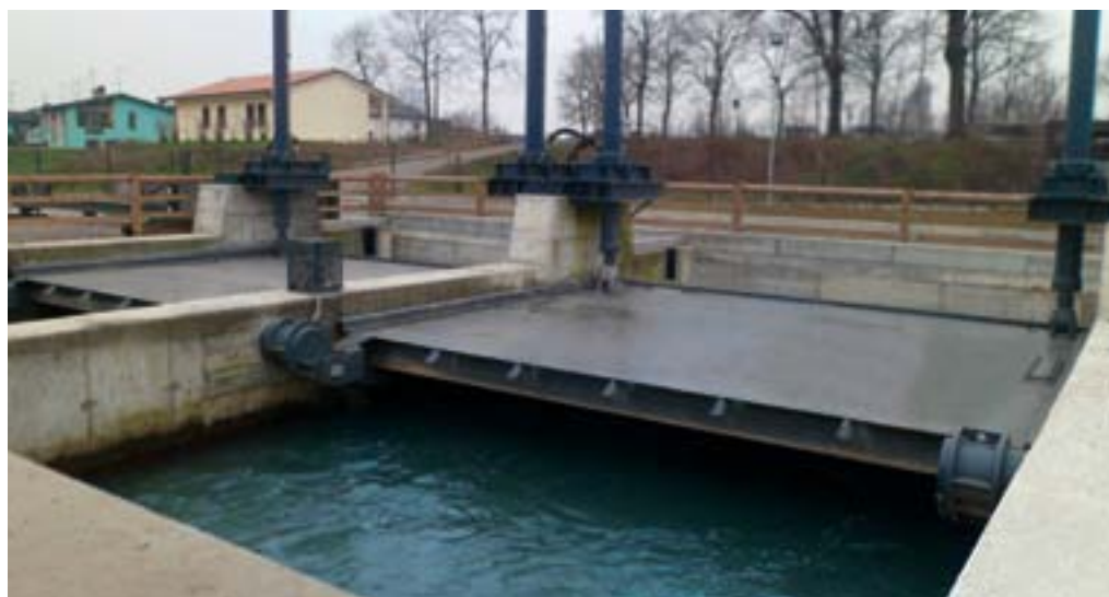
Impinato mini idroelettrico, Comune di Isola Dovarese (CR)
