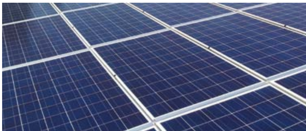
Impianto fotovoltaico su copertura scuola materna, Comune di Renate (MB)
