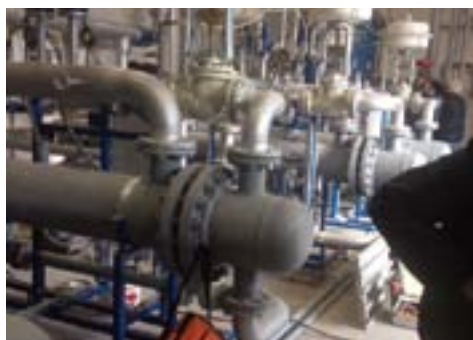
Centrale geotermica, Comune di Montieri (GR)
