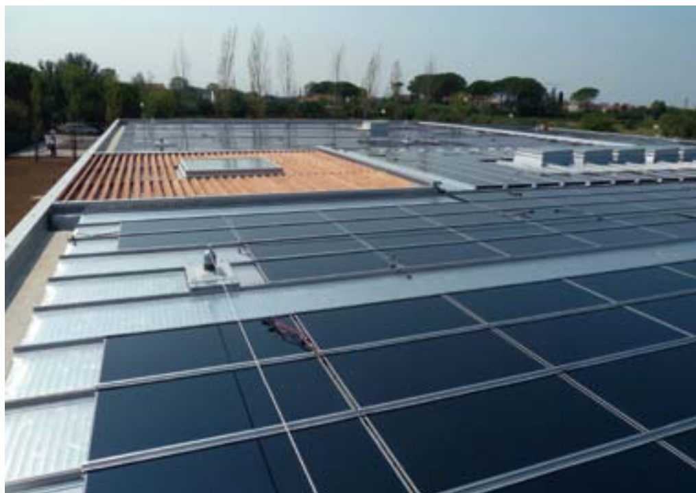
Pannello solare termico nel Comune di Cascina (PI)
