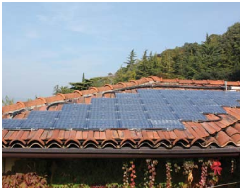
Impianto solare termico su tetto di un’abitazione privata, Comune di Vittorio Veneto (TV)
