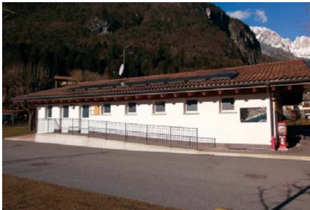
Impianto solare termico su copertura camping, Comune di Molveno (TN)
