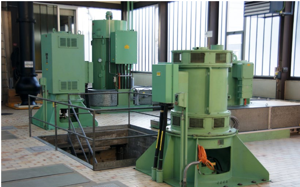
Haupt- und Hilfskühlwasserpumpen im Maschinenhaus. Foto: KKM
