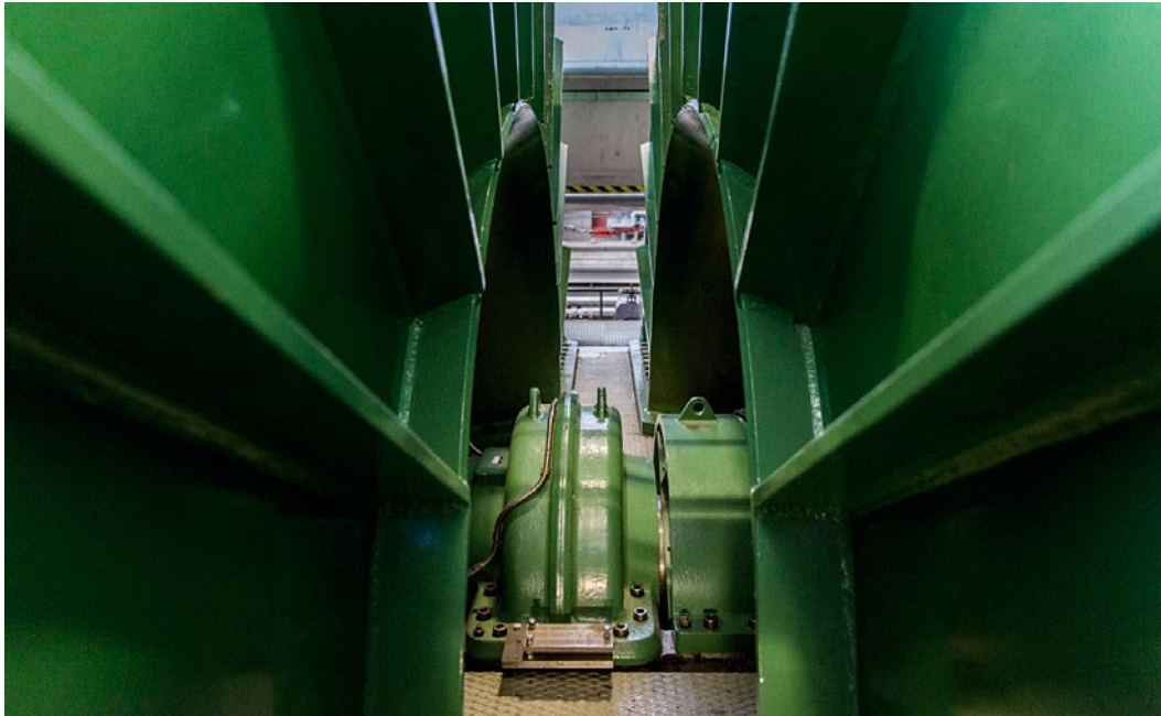
Turbinengruppe. Foto: KKB
