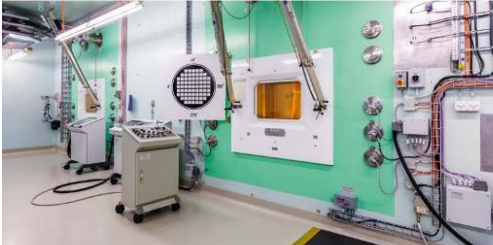
Bedienungsraum für die Heisse Zelle. Foto: Zwiilag
