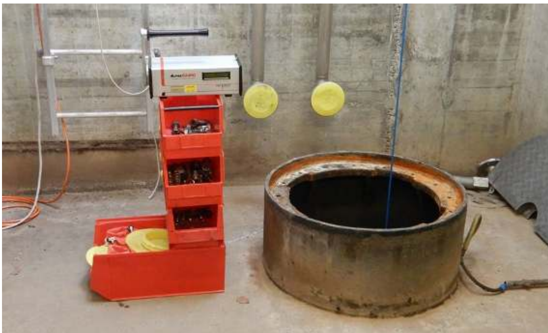
Bild 2: Radon-Screening-Messung bei einer Grundwasserfassung in einem KKW.
