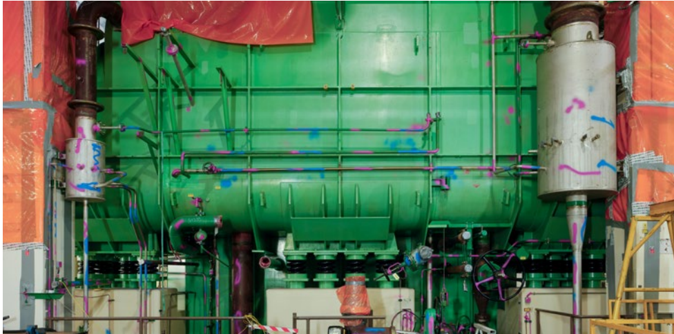
Systeme, die ausser Betrieb sind, werden markiert. Foto: BKW
