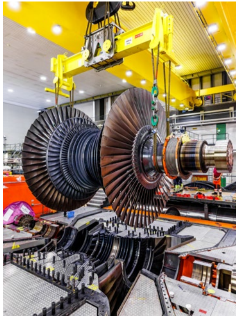
Niederdruckturbine. Foto: KKG
