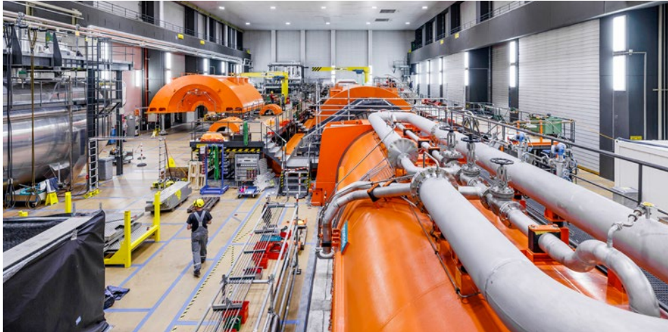
Generator. Foto: KKG
