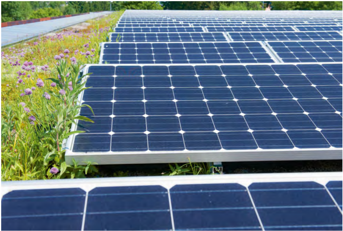
L'installation photovoltaïque sur le toit du Centre des collections d'Affoltern am Albis.
