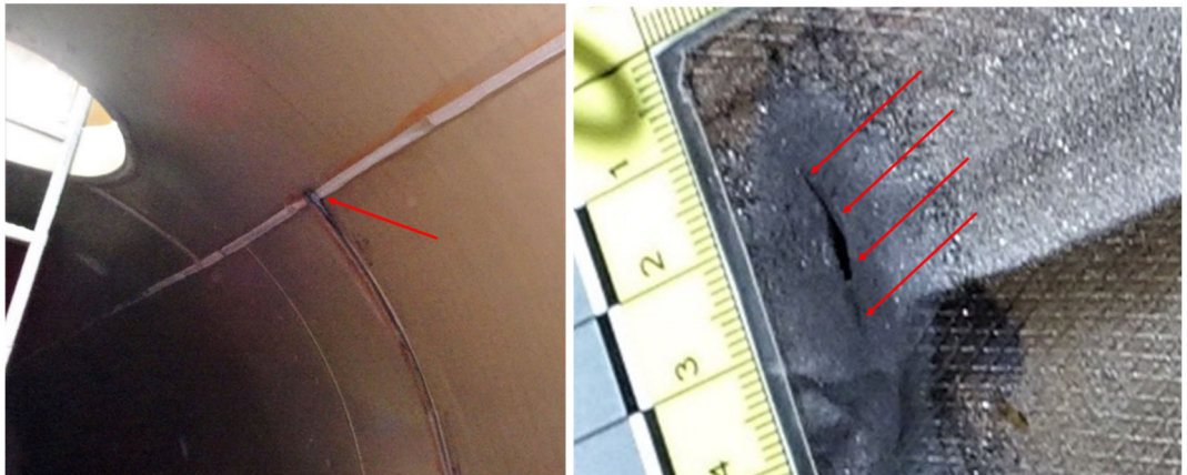
Abbildung 7: Linkes Bild: Übersicht im Tankinnern (Pfeil zeigt auf den Riss). Rechtes Bild: Riss in der Schutzauskleidung.
