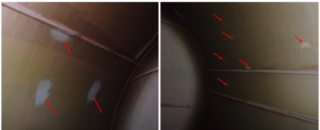
Abbildung 8: Einige der im Tank vorgefundenen Schleifspuren (rote Pfeile).
