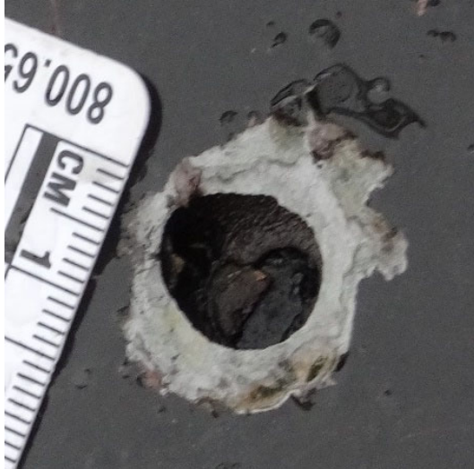
Abbildung 6: Ausprägung der Lochstelle im Stahlmantel.
